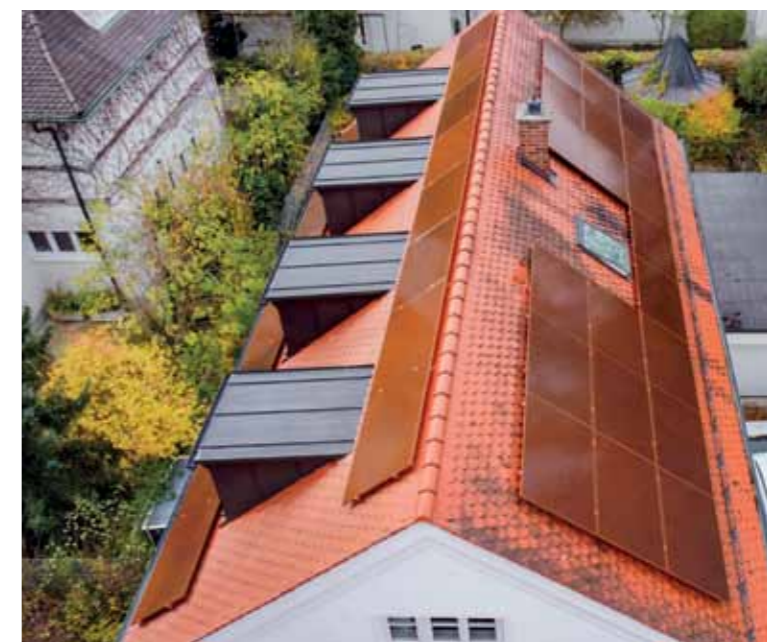
Gut integriert: Solaranlage auf denkmalgeschütztem Haus in München
